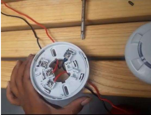
Gambar 3. Kerusakan pada Smoke Detector
