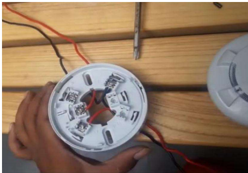
Gambar 3. Kerusakan pada Smoke Detector
